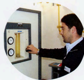
Dosificació de clor a la instal·lació de postcloració.
