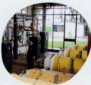
Instal·lació de precloració.
