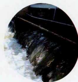
Entrada de l'aigua als decantadors.
