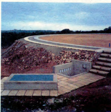
Bassa d'infiltració-percolació, arqueta de mostreig i arqueta de recollida
